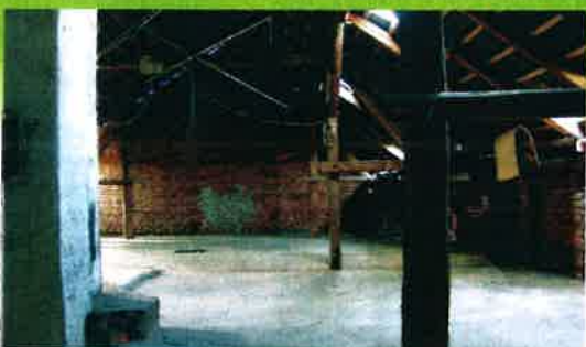
Pohled na vyklizenou půdu před započatím vytvoření nové pochozí podlahy, povrch není rovný a strop dostatečně neizoluje.
